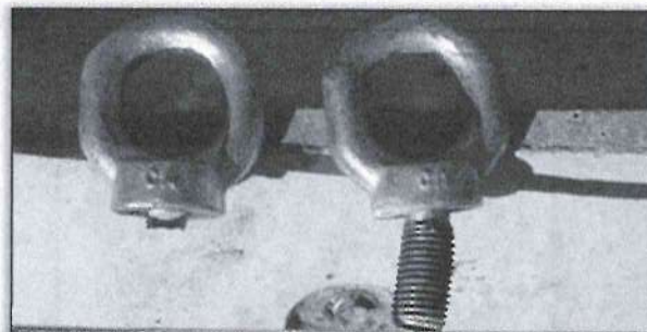
DEFORMACIONES EN EL CÁNCAMO
